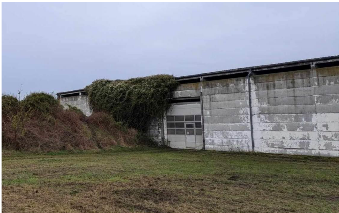
Foto 4-5: Gebäude 4 – Einflugmöglichkeiten im oberen Bereich zwischen Gebäudemauer und Dach.
